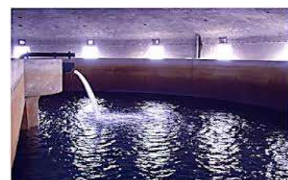
Entretien et fonctionnements des réseaux des installations de distribution d'eau destinée à la consommation humaine.
