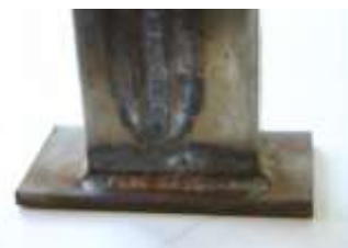
1) Inox : cordon de soudures avec dépôts d'oxydes
